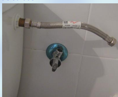
Figura 1: Toma de la Cisterna
